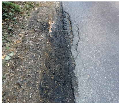
Fot. 1. Deformacje i spękania nawierzchni asfaltowej wzdłuż krawędzi na drodze lokalnej dla samochodów osobowych w Niewodnicy Kościelnej woj. podlaskiej po miesiącu użytkowania
