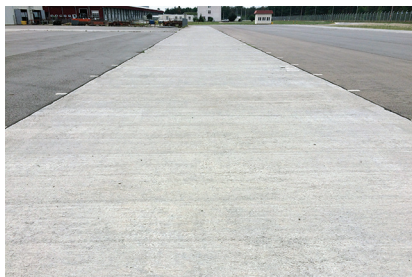
Fot. 5. Nawierzchnia drogowa z betonu cementowego modyfikowanego emulsją bitumiczną po 3 latach eksploatacji
