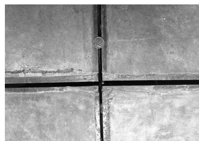
Fot. 3. Krawędzie płyt posadzki bezspoinowej w miejscu dylatacji Photo 3. The edges of the jointless floor at the expansion joints
