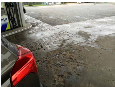
Rys. 2. Uszkodzenia nawierzchni betonowej na stacji paliw przy drodze krajowej nr 8 w Zabrodziu w woj. mazowieckim w wyniku ekspozycji na agresywne oddziaływanie środowiska. Fot. Autor
