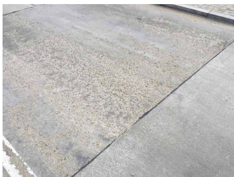
Rys. 1. Złuszczenia po 2 latach użytkowania nawierzchni przy Zakładach Mleczarskich „Mlekovita” w Wysokiem Mazowieckiem w wyniku cyklicznego zamrażania i rozmrażania. Fot. Autor
